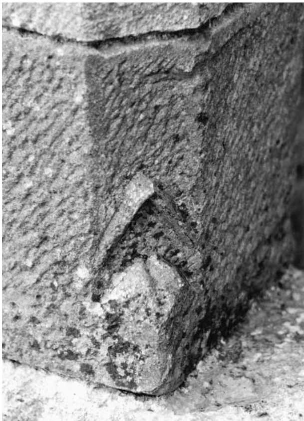
Fig. 47 : Porte de Lyere : porte sud du 2 nd niveau, amortissement du piédroit ouest.
